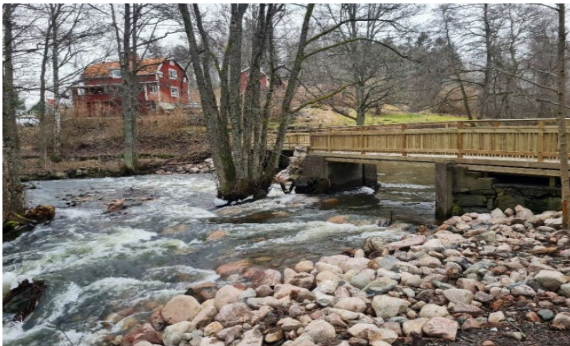
Figur 6. Trosa kommun genomförde 2022 ett fondprojekt i syfte att underlätta fiskvandring. Bilden visar Nygårdsdammen efter åtgärd. Det tidigare vandringshindret är numera passerbart för vandrande fisk. Projektet har fått finansiering av Bra Miljöval Miljöfond.
