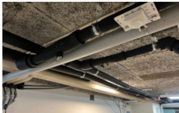
Rördragning taket i källare
