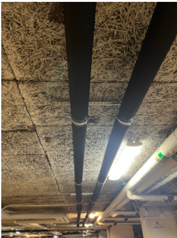
Rördragning taket i källare
