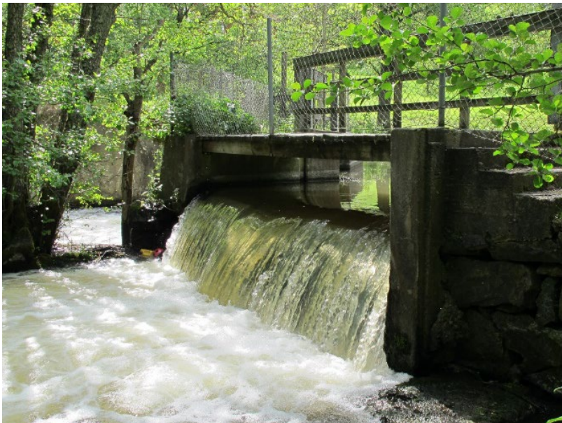
Nygårdsdammen före åtgärd. Foto: Trosa kommun.
