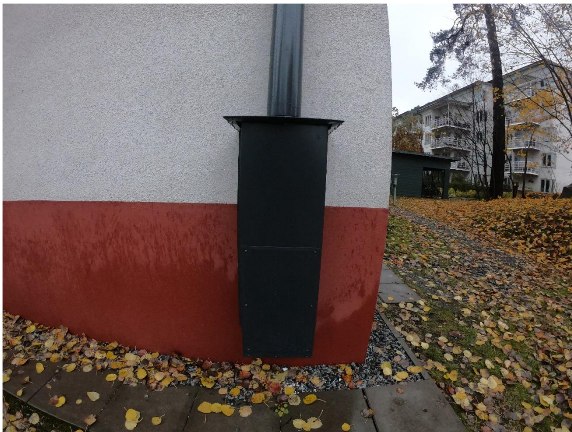
Rör genomföringen från taket till undercentralen Skeppargränd 5
