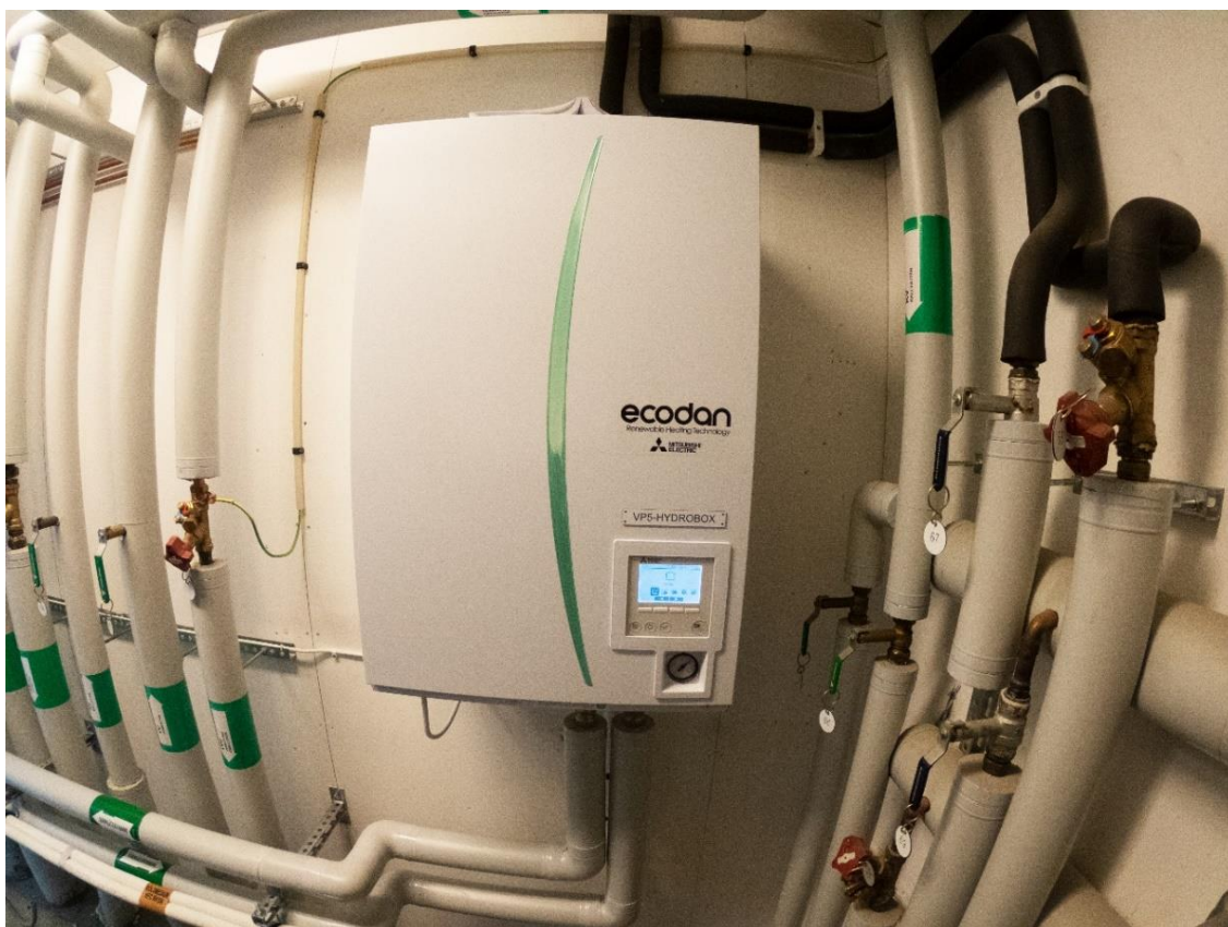
Hydroboxen i undercentralen Skeppargränd 5
