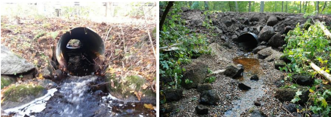
Vägtrumman före respektive efter åtgärd under 2017. Justeringar av trumman gjordes därefter under 2018.
