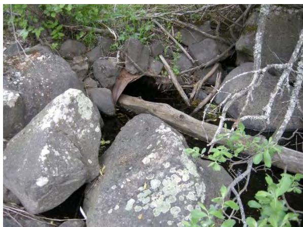
Underdimensionerad, endast 0,6 m vid vägtrumma.
