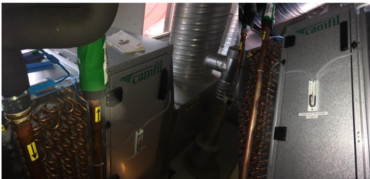
Vä: Bild som visar rör med frånluft som tas in till värmeväxlaren och återvinns via köldmedel som leds ner till källaren. Hö: Närbild på värmeväxlare
