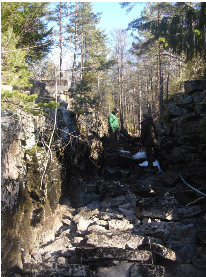
Foto 1. 2013-04-05 (före åtgärd). Kanalen/ravinen under inspektion vid planering av åtgärd.
