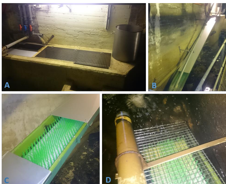
Figur 7. Förbättringsåtgärder av ålyngeluppsamlaren vid Laholms kraftverk 2015. A) Predationsskydd över sump och "vittjningssil". B) Predatorskydd över ramp. C) Nytt vandringsmedie Fish Pass™. D) Rostfritt galler på den nedre sektionen av rampen (galler är nödvändigt pga. nivåfluktuationer).
