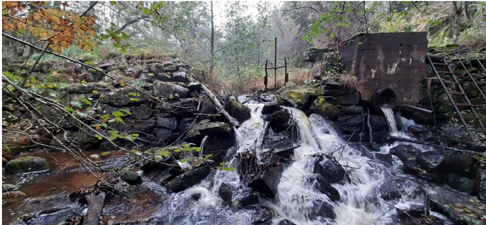
Figur 17. Det fjärde vandringshindret i Brattorpsån utgörs av en delvis raserad kraftverksdamm.
