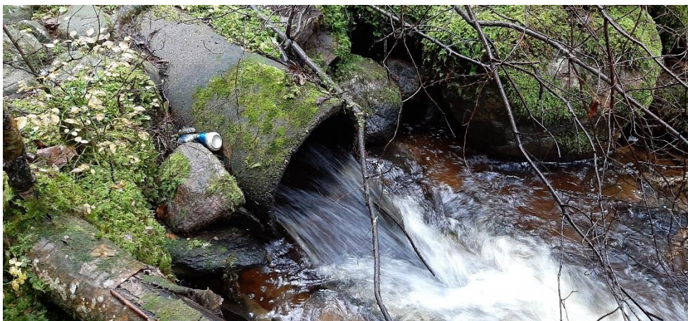
Figur 19. Det sista hindret i Brattorpsån utgörs av en illa placerad betongtrumma strax innan Arsjöns utlopp.
