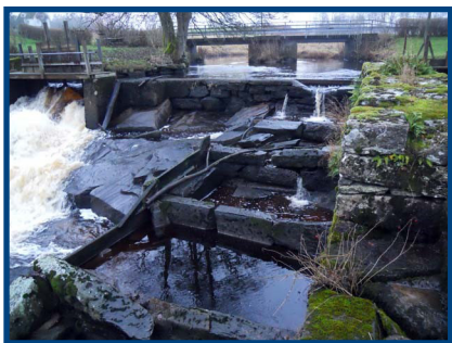
Fisktrappan vid Mølnebacka kraftstation i Surtan är ur funktion. Det gör att vattenförekomsten ej når upp till god ekologisk status.
