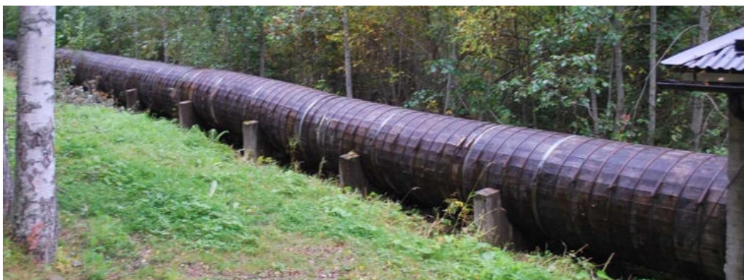
Trätuben som för Tunsjönans (Bruksån) vatten ned till kraftverket.
