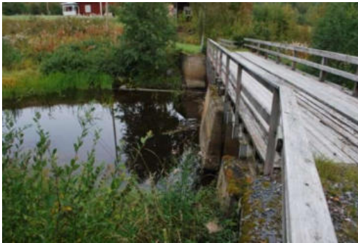
Dammen/bron som utgör ett vandringshinder.
