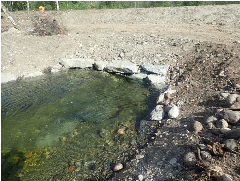
Et plastrør (dykket) sørger for vanngjennomføring i elveforbygningen.
