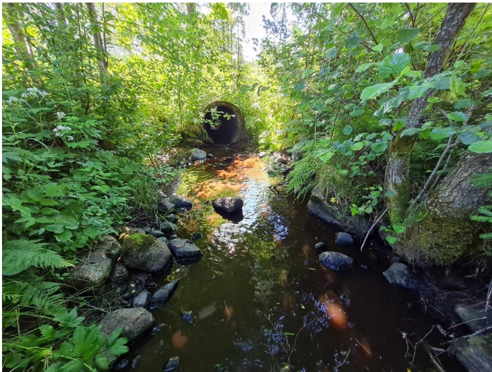
Figur 16. Sträcka i Brännebäcken före åtgärd.
